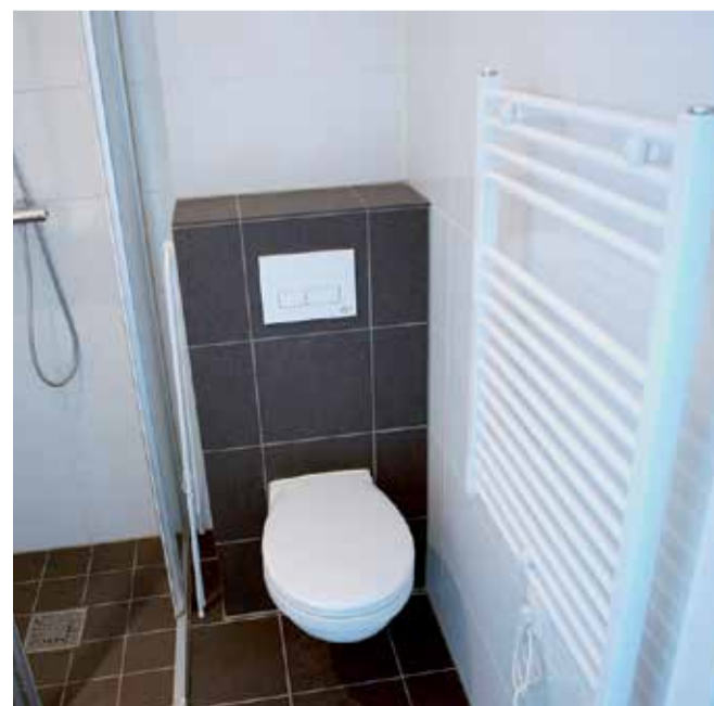
Een stekkerklare oplossing voor de verwarming in de badkamer scheelt veel installatiewerk.
